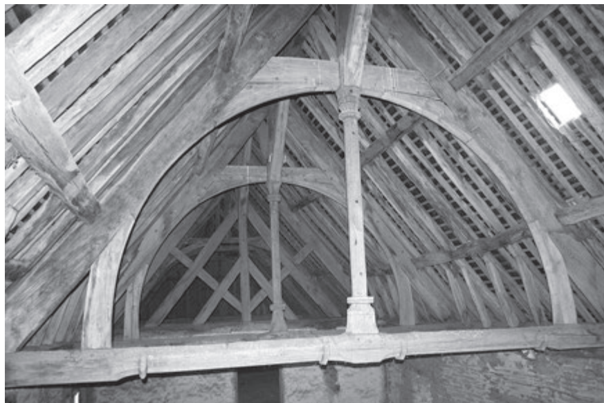
Figure 2 – Bréal-sous-Montfort (Ille-et-Vilaine), manoir du Molant, vue générale de la charpente mise en œuvre pendant l’hiver 1385-1386 (© cl. C. Olivier)
