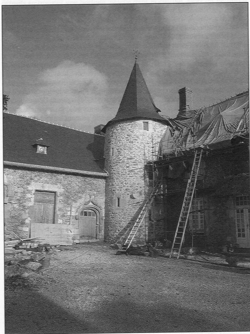
Figure 24 – La Héliardière : la salle basse, sa grande porte et la tourelle d'escalier, avec la nouvelle couverture, vues de la cour intérieure. La toiture de l'aile était toujours en travaux.
